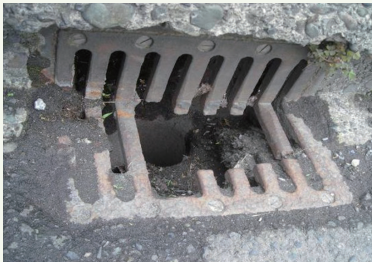
铸铁製排水柵蓋①
