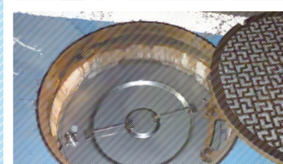
電線共同溝のセキュリティ対策 内部に設置する内蓋
