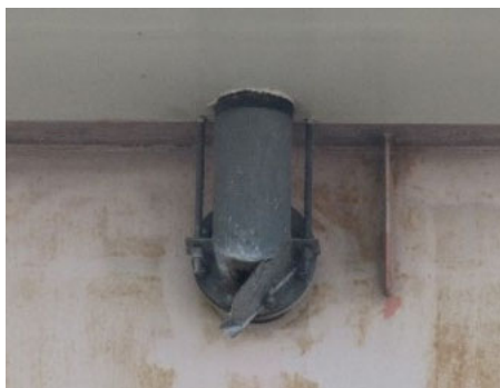
写真-1 鋼製排水管の損傷状況
