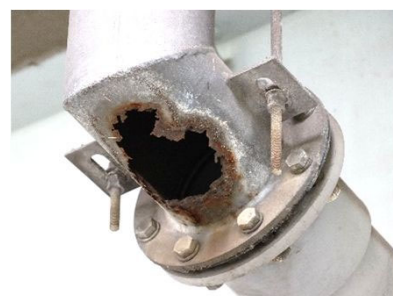
穴があいた鋼管エルボ
